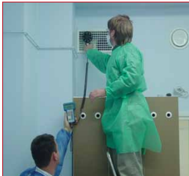
Controles de la ventilación llevados a cabo por un equipo de especialistas ambientales
